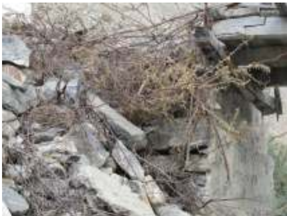
Opěrné zdi zbořila velká voda
