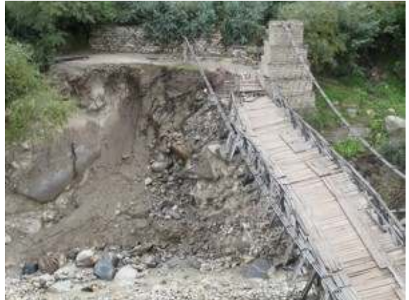
Velká voda utrhala mosty
