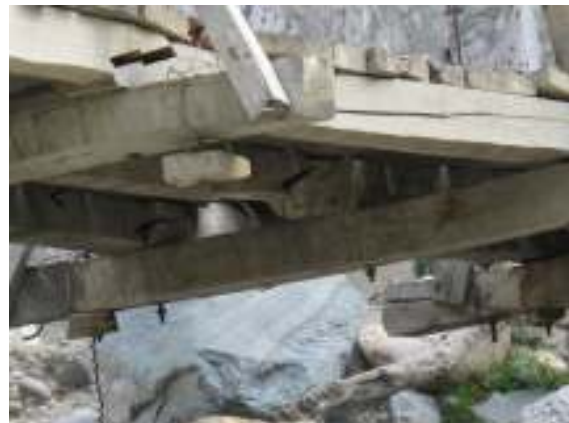
Nosníky mostu jsou prasklé
