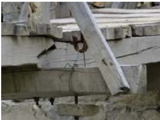
Provizorní nebezpečné uchytení
