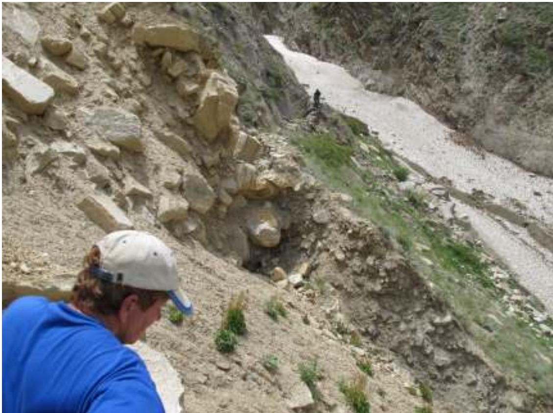
Stržený vodní kanál sesuvem svahu
