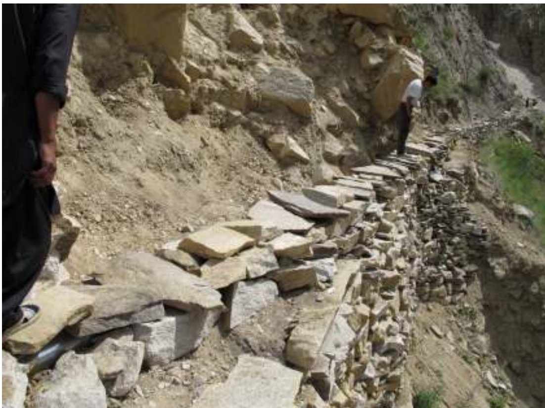
Vyzděný stržený úsek
