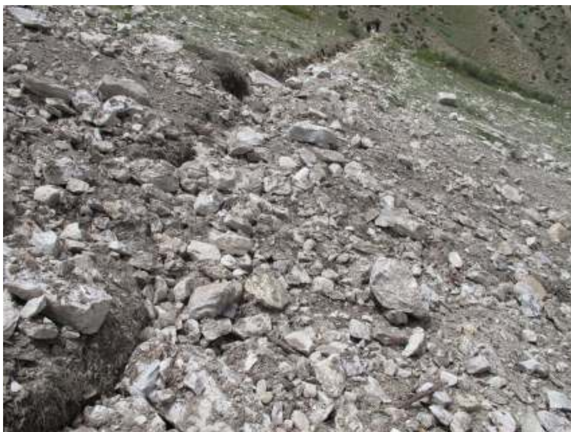
Zavalený úsek vodního kanálu způsobený lavinou
