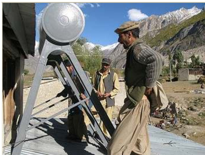
Solar Water Heater na střeše mešity
